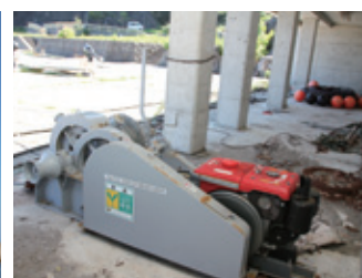
●堀内漁港 電気がなくても動かせるエンジン式(写真)を含む計4台の巻揚げ機を導入
