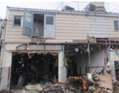
津波で使用不能になっている鎌田水産の冷蔵庫 (大船渡市)
