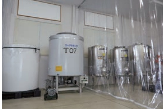
真新しいサーマルタンクと発酵タンク(右奥)
