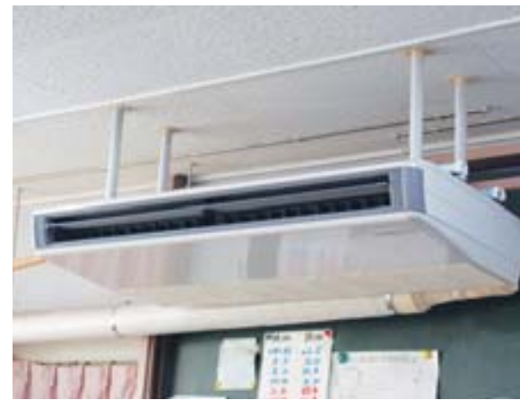
助成で新しく設置された冷暖房設備
